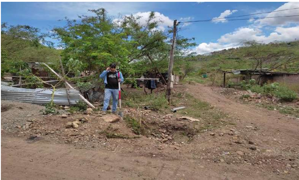
Alineamiento de las calles de la ciudad de Jaén por parte de los técnicos topógrafos
