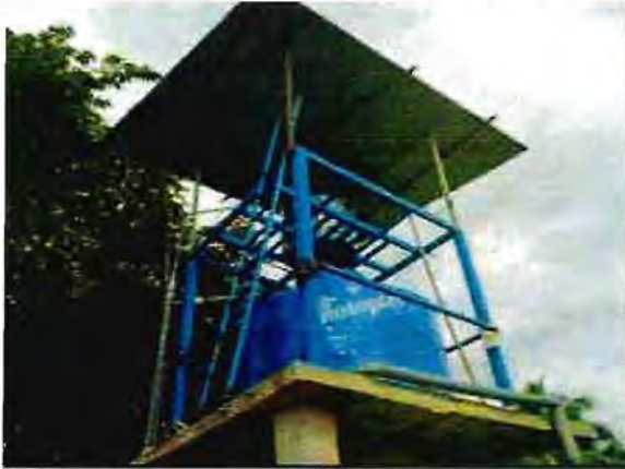
FOTO 55: Reservoiro de la JASS-LAS BALSAS, equipado con sistema de cloración, infraestructura de metal para la protección de los tanques dispensadores del servicio de agua y techo. EL sistema se encuentra completo y operativo.
