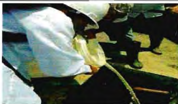
FOTO 61: En el siguiente proceso se vierte la disolución previamente reposada en los componentes del sistema, principalmente en los reservorios para desinfección y el tanque elevado para cloración; el tiempo de actuación depende de si la actividad es desinfección o cloración.
